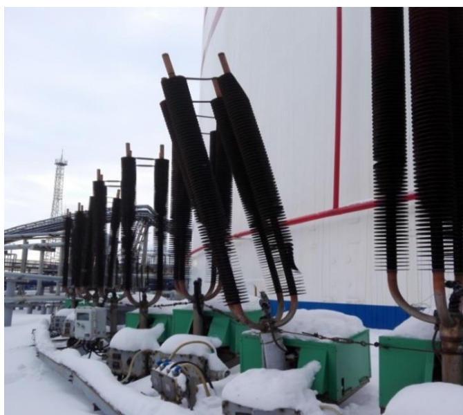
Рис. 2 – Термостабилизаторы на РВС-50000
